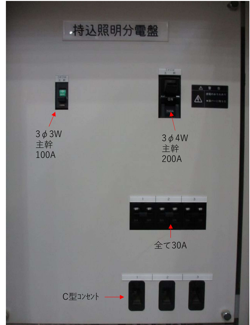
持込用分電盤 (既設)
